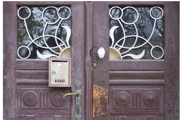
GREȘIT! Din păcate, la poarta originală, unele piese istorice au fost înlocuite cu elemente noi, nepotrivite pentru clădirea istorică.
