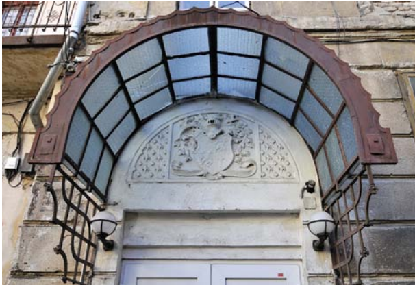
MERITĂ A FI RESTAURATĂ! Copertină cu valoare estetică evidentă, care trebuie urgent restaurată.
