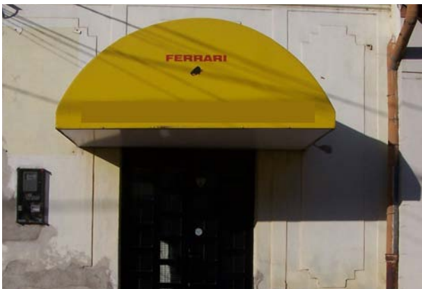
GREȘIT! Copertina, supradimensionată, este executată din material plastic. Ea nu se potrivește nici cromatic cu fațada inițială.
