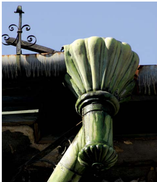
VALOARE ESTETICĂ! Vazon istoric de legătură, între jgheab și burlan, și cârlige de jgheab istorice. Ele trebuie neapărat conservate și restaurate.
