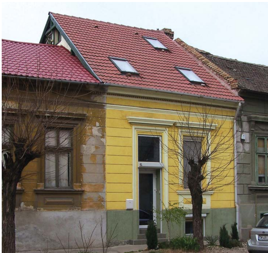
GREȘIT! Intervențiile constructive noi, în zona acoperișului, deteriorează aspectul istoric al clădirii.
