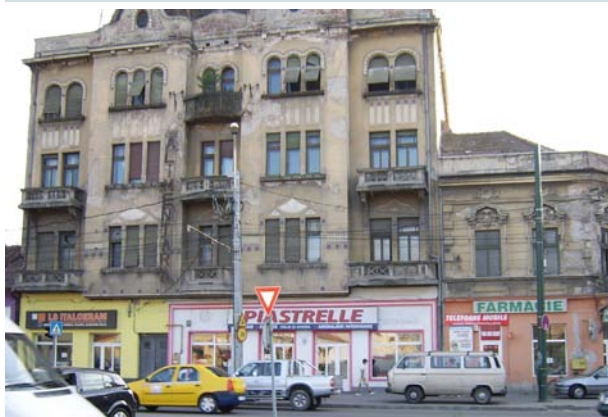
GRESIT! Atât cromatica vitrinelor, cât și culorile zidăriei parterelor, contravin expresiei arhitecturale generale a ansamblului.
