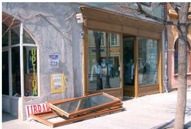
RECOMANDABIL! O vitrină cu rame din material plastic, PVC, este înlocuită cu o alta cu tâmplărie din lemn, adecvată fațadei istorice.
