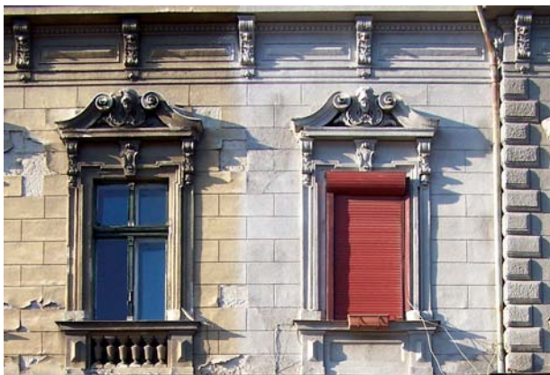
GREȘIT! Fără a se ține cont de materialele istorice, fațada a fost tratată în mod necorespunzător, cu tencuială de ciment "stropită".
