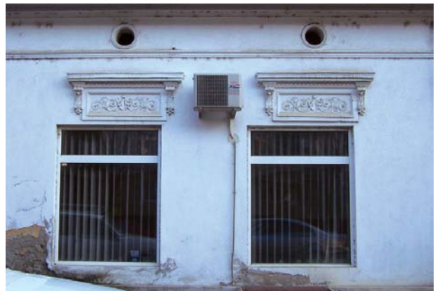
GREȘIT! Ferestrele din material plastic, PVC, au fost montate fără nici un respect față de clădirea istorică.
