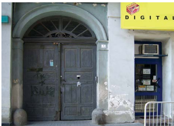
REGRETABIL! Poartă istorică neîngrijită și parțial deteriorată. Ușa de intrare la magazinul din dreapta nu se potrivește cu fațada istorică. Este executată din PVC, un material neadecvat pentru cartierele istorice.
