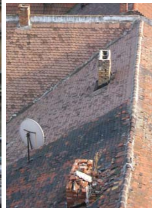
Coșuri de fum deteriorate, încălzirea nu poate funcționa corect.
