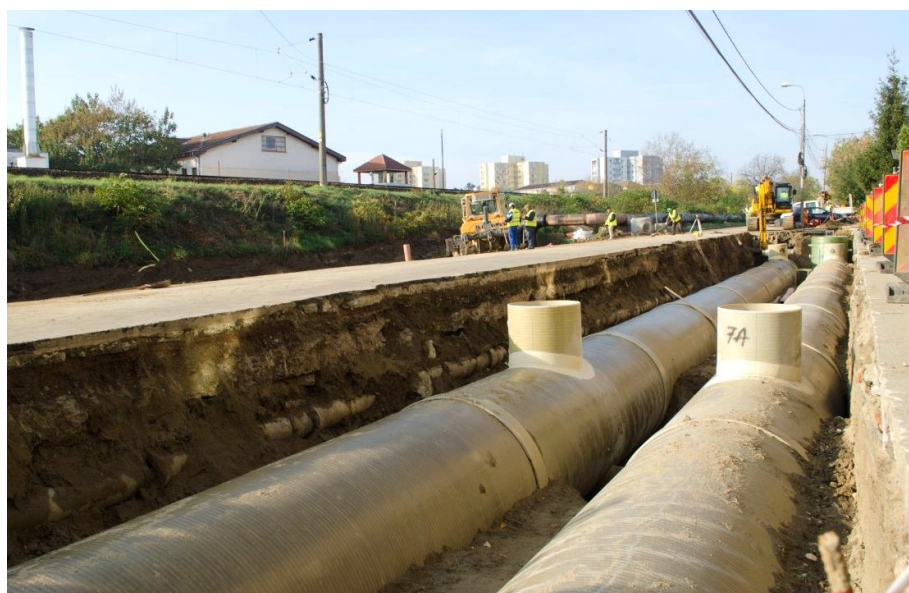
Foto: Soluții locale, implementate de Aquatim, pentru gestionarea debitelor mari de apă de ploaie – Pasaj CFR/Str. Popa Șapcă: bazin tampon de retenție, stație de pompare și vane acționate electric (SCADA), ptr. deversarea controlată în canalizare
