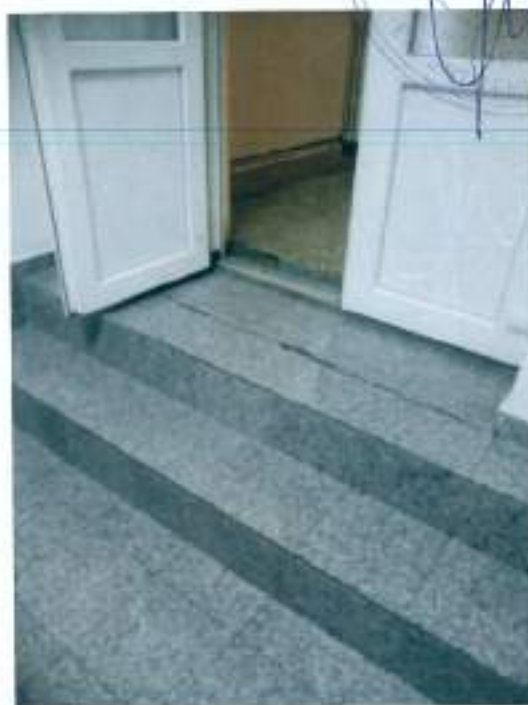
Foto nr. 4. Acces Corp P+1 spre corp D+P+2E+M (fisură)
