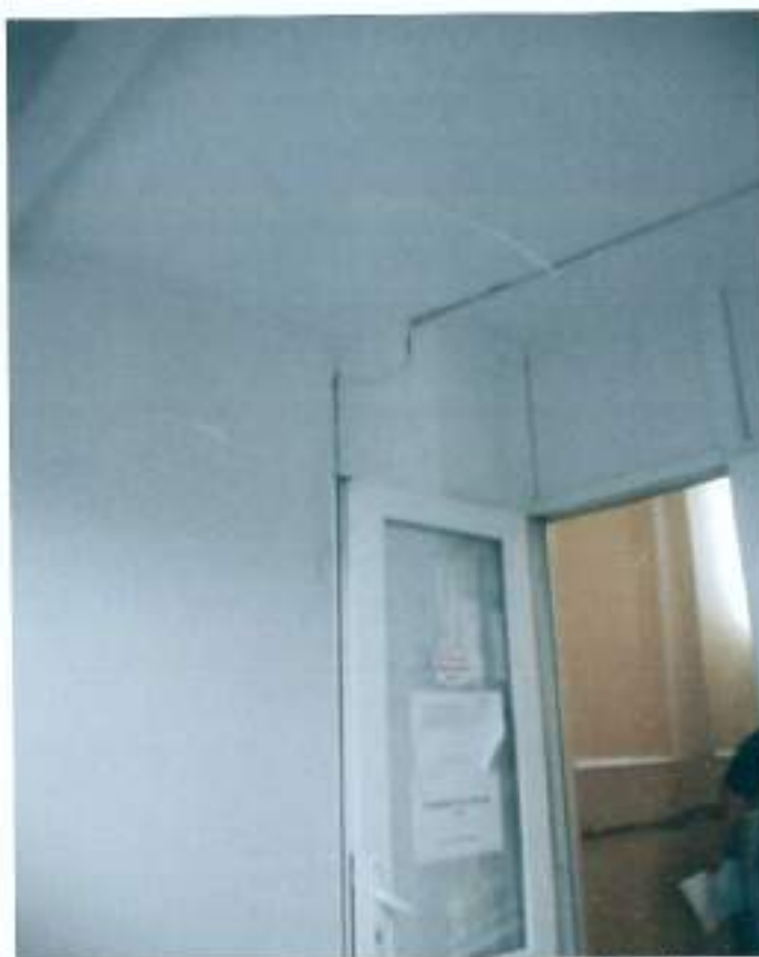
Foto nr. 5. Acces Corp P+1 spre corp D+P+2E+M (fisură - nestructurală)
