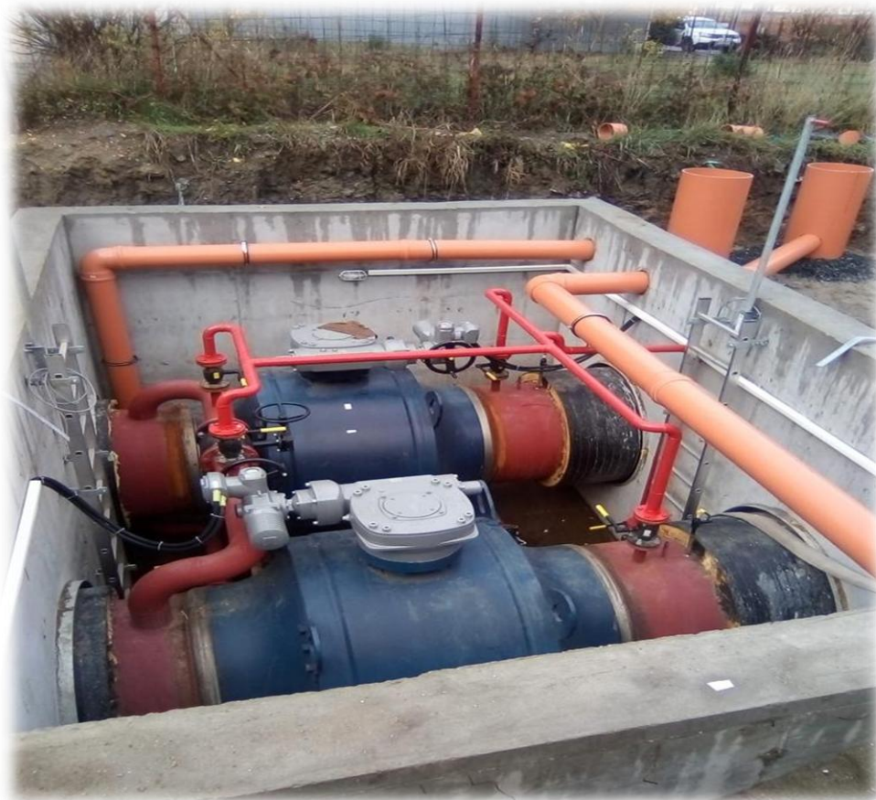
Cămin vane de secționare - Retehnologizare rețea termică primară Obiectul 1
