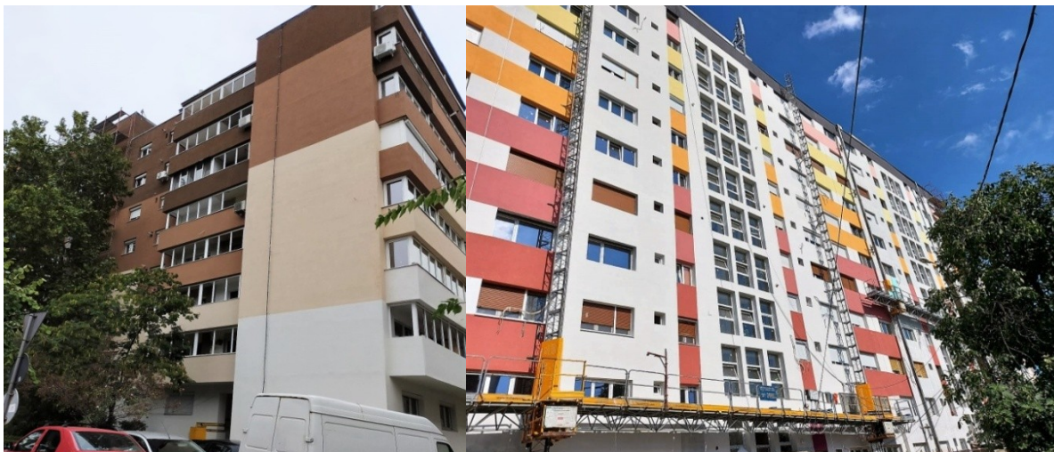
Imagini de la blocuri la care a fost finalizată reabilitarea termică în 2021
